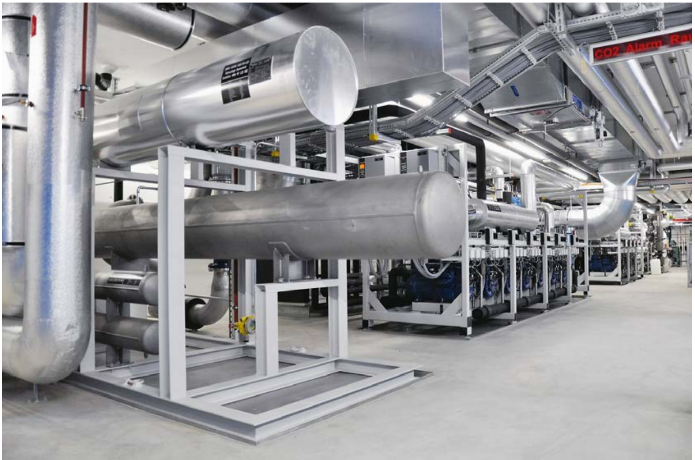
Beispiel transkritische CO 2 -Verbundanlage (Sportzentrum Heuried).
